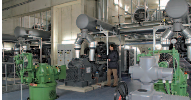
Dieselantriebe gewährleisten einen autarken Betrieb des Hochwasserpumpwerkes.
