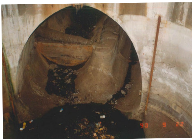
▼ Der Dükereinlauf am Flügelweg, 1990 (Foto: privat)
