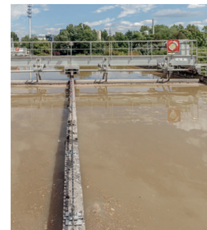
In den Vorklärbecken werden Fette und kleinste Feststoffe aus dem Abwasser entfernt.
