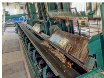
Über Förderbänder wird das Rechengut in Container transportiert
