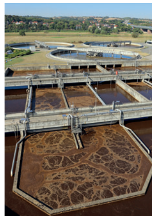
Herzstück der Kläranlage: die Behandlungsbecken der biologischen Reinigung
