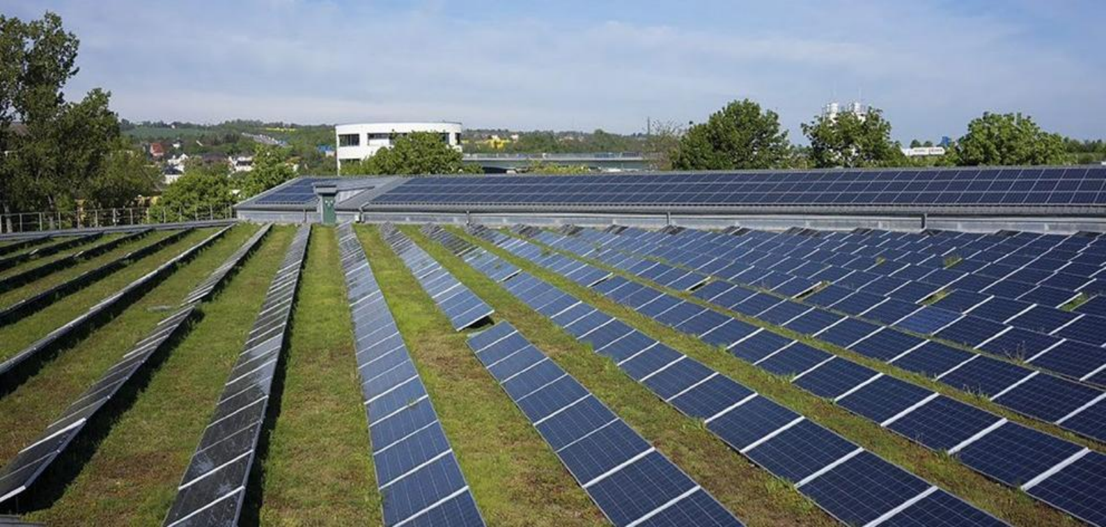
Abb. 19: Photovoltaikanlage auf der Kläranlage Dresden-Kaditz
