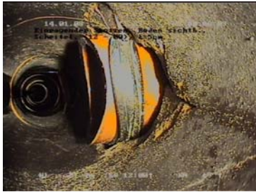
einragend, Zerstörung Hauptkanal
