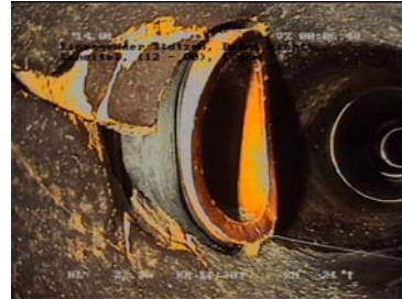
einragend, Zerstörung Hauptkanal
