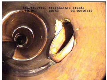
einragend, undichte Rohrführung
