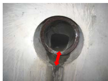
nicht bündig zur Kanalwandung
