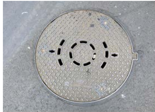
Bild D 64: mit Lüftung
