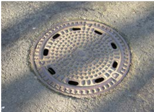
D 400 Abdeckung (Berliner) Vollguss, Deckeldurchmesser 68 cm → Bauhöhe 11 cm
