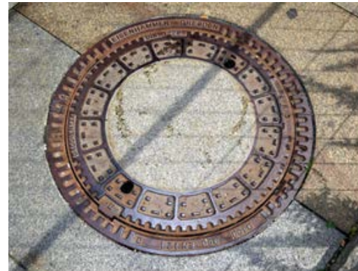
Bild D 36: ohne Lüftung
