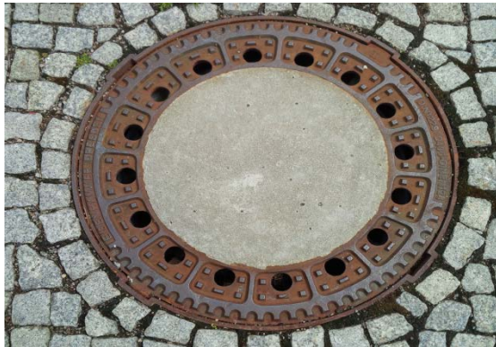
Bild D 7a: mit Lüftung
