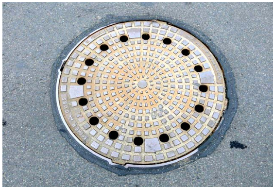
Bild D 2a: mit Lüftung
