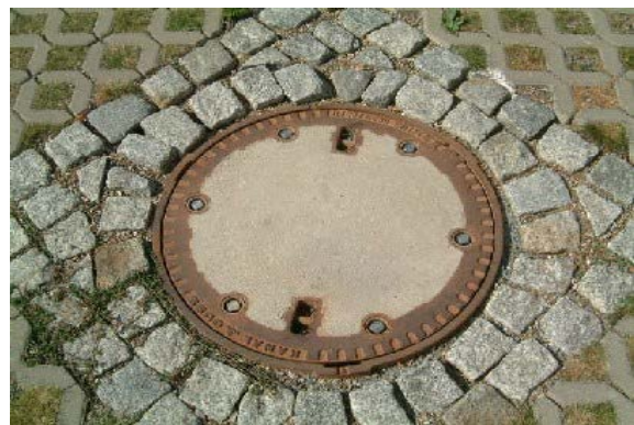
D 400 Abdeckung (tagwasserdicht)
