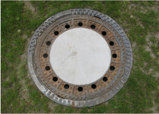
Bild D 6a: mit Lüftung
