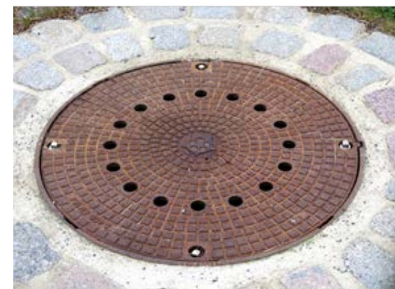
Bild D 62: mit Lüftung
