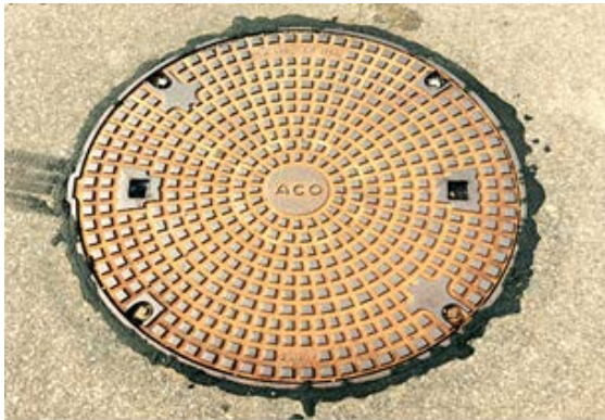
Bild D 63: ohne Lüftung
