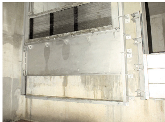
Rechts: Beispiel für Bauwerkstyp B: Regelschieber Bundschuhstraße und Absenkschütze mit automatischer Siebrechenanlage, Entlastung in die Elbe
