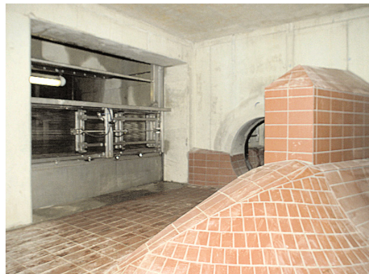
Abbildungen 17/18: Links: Beispiel für Bauwerkstyp A: Doppelschieber im Neustädter Abfangkanal, 2900 x 2000, mit angeflanschten Regelschieber DN 1200, Vorderseite/Rückseite
