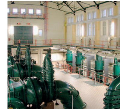
links: historische Regenwetterpumpen rechts: moderne Schmutzwasserpumpen
