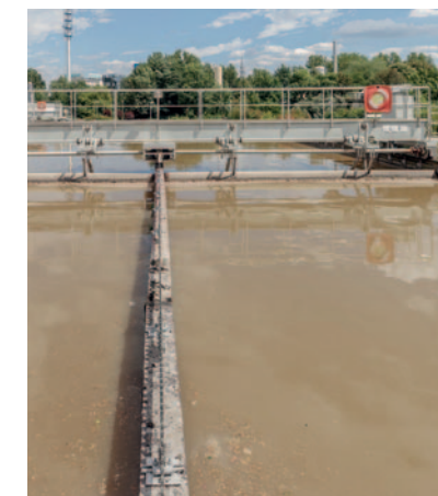
In den Vorklärbecken werden Fette und kleinste Feststoffe aus dem Abwasser entfernt.
