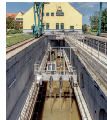
Im Sandfang wird der abgesetzte Sand von Saugräumern entfernt.
