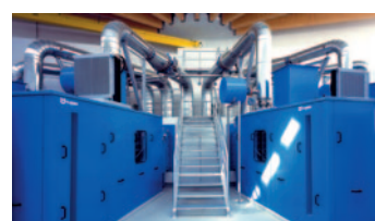
Sechs riesige Turbogebälse versorgen die Belebungsbecken mit Druckluft.
